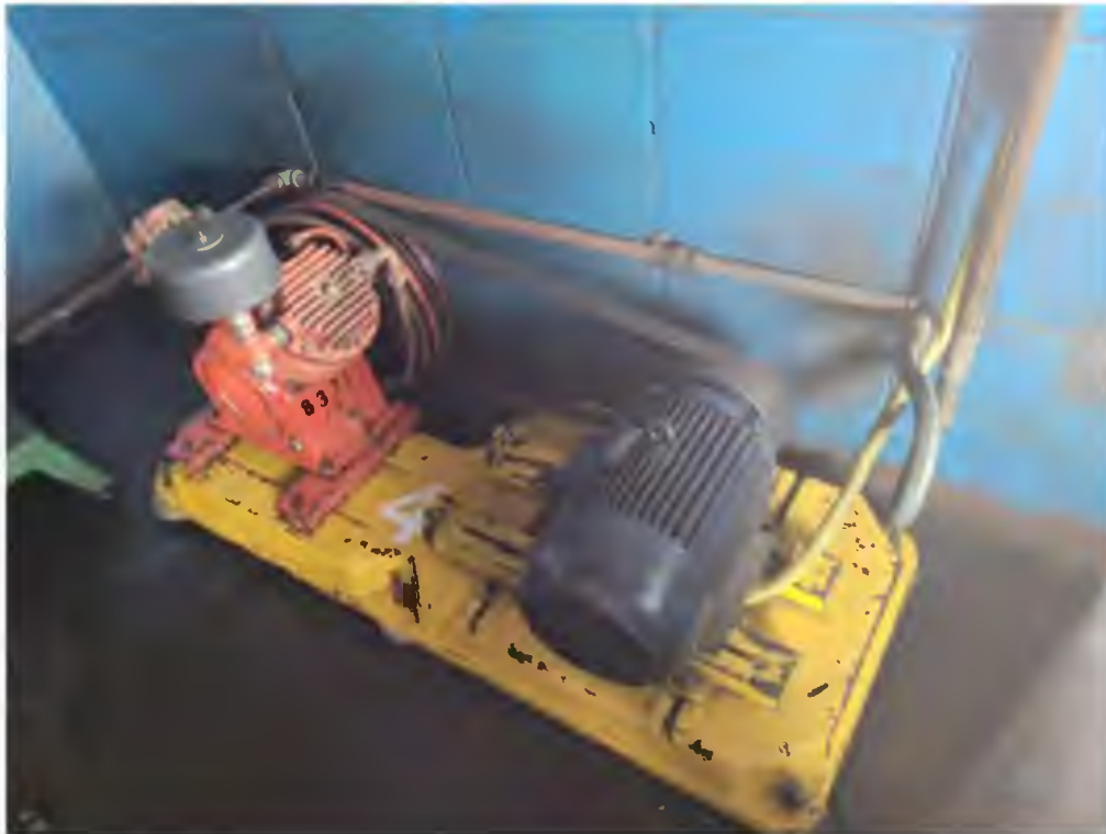
Bomba D'Água Poço Artesiano
