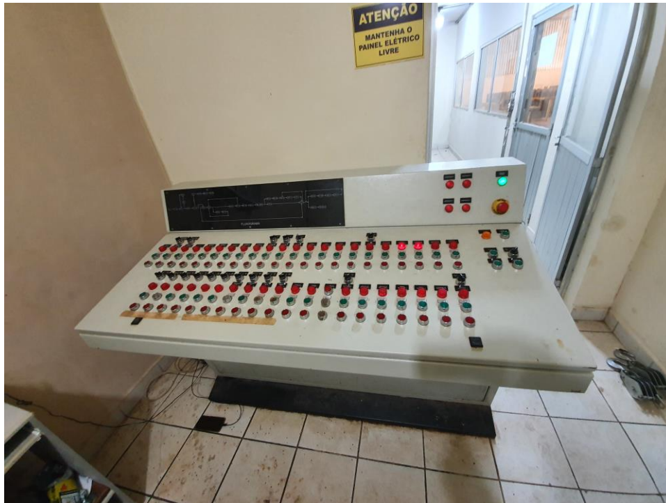
Foto 47 – Vista Interna do Galpão de Máquinas de Limpeza: Sala de Comandos
