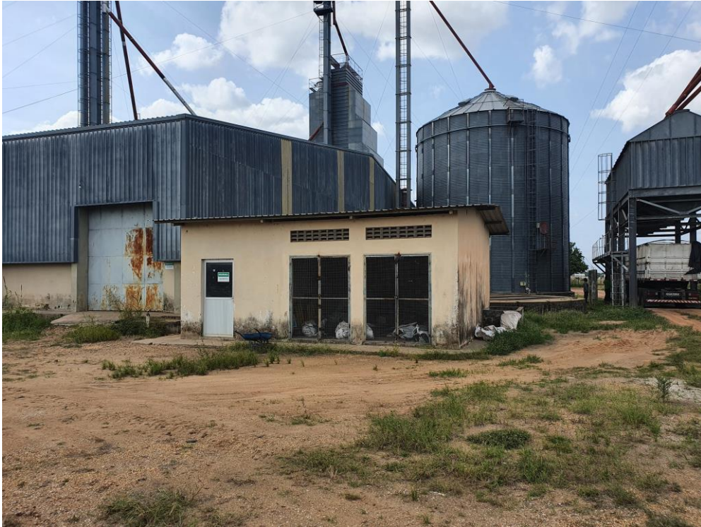
Fotos 36 e 37 – Vista da Casa de Força (Grupo Gerador)
