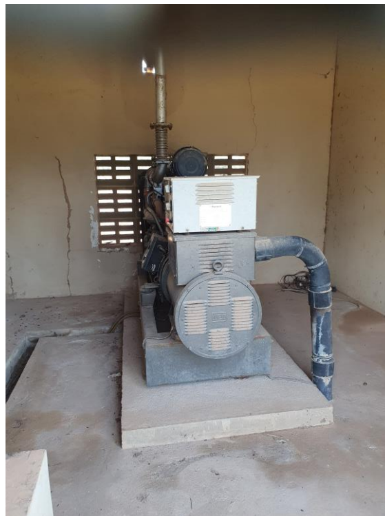
Foto 35 – Vista da Casa de Força (Grupo Gerador)
