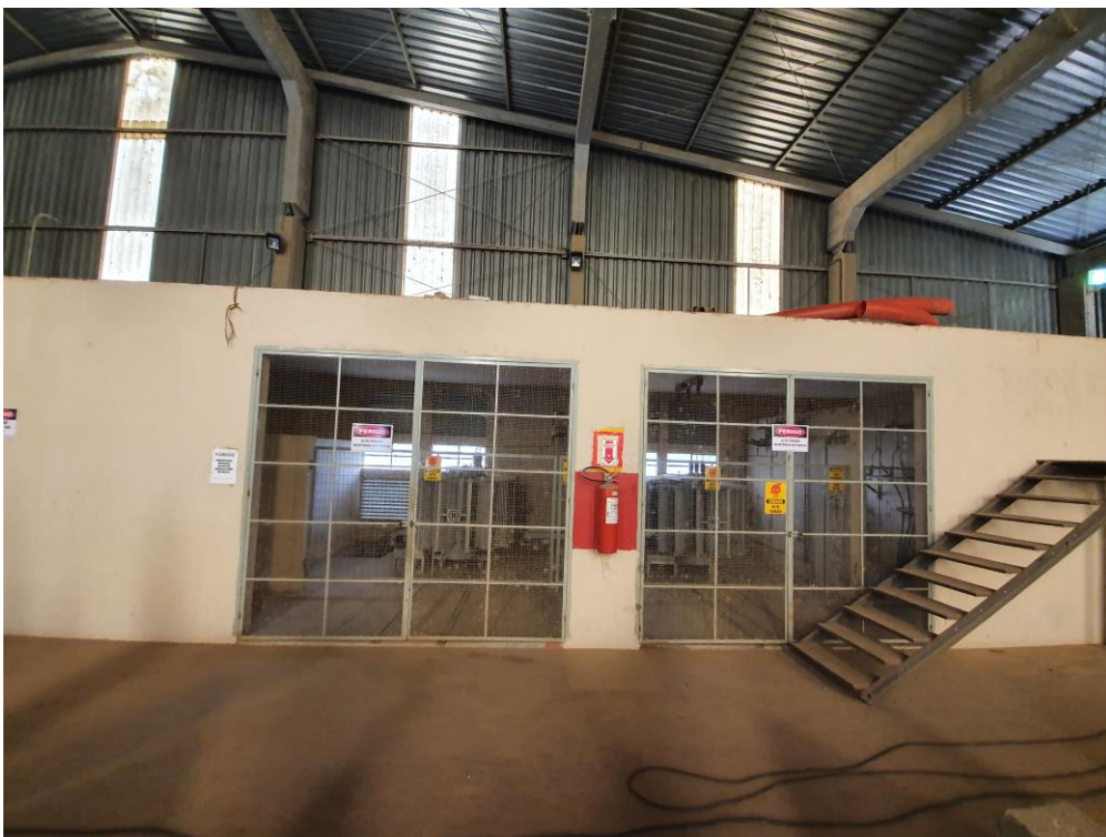
Foto 46 – Vista Interna do Galpão de Máquinas de Limpeza: Transformadores de Alta Tensão
