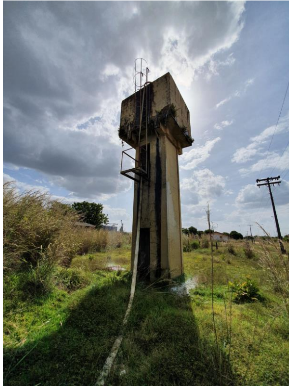
Foto 26 – Vista da Caixa D`água (Com vazamentos)
